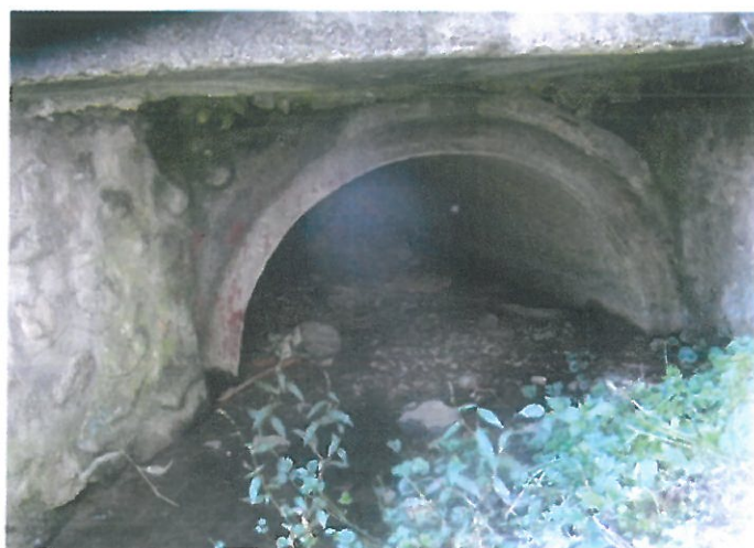
Podete transversale colmatate pe DJ 671
