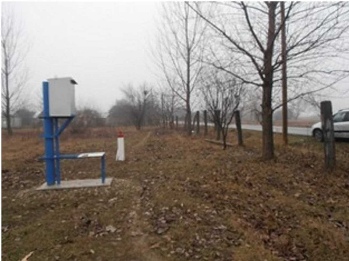
POZA 1 – Statie protectie catodica amplasata la margine drum DJ701A.
