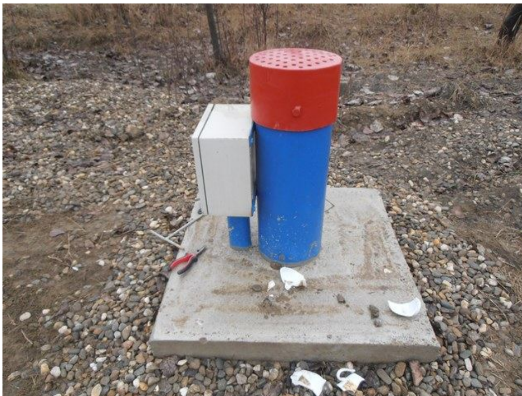
POZA 2 – Rasuflatoare cu capac gaurit si prize de potential tip cutie montata pe rasuflatoare
